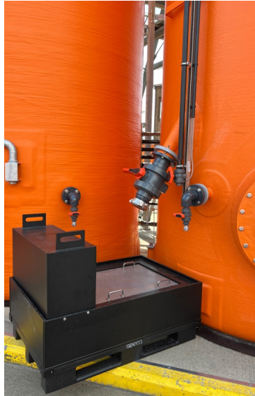
Installation de saumure Percostrasse Vienne
