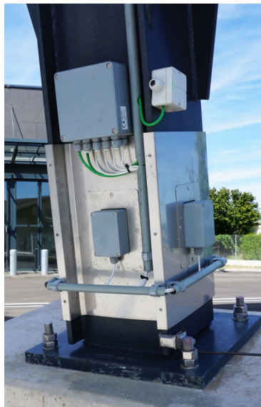
Steuerschränk und Pumpe der Salzlöseanlage Vario
