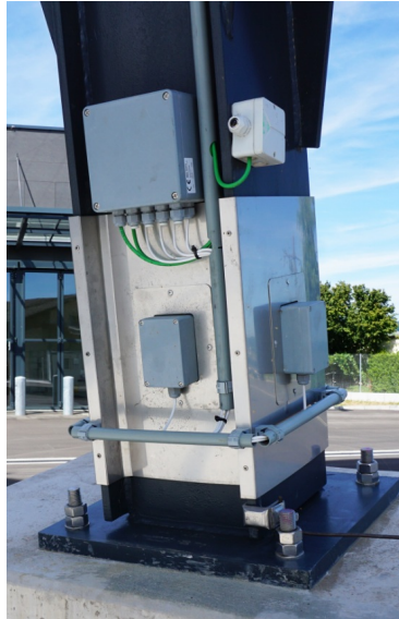
Steuerschrank und Pumpe der Salzlöseanlage Vario
