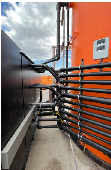
Leitungsführung hinter dem Pumpenschrank
