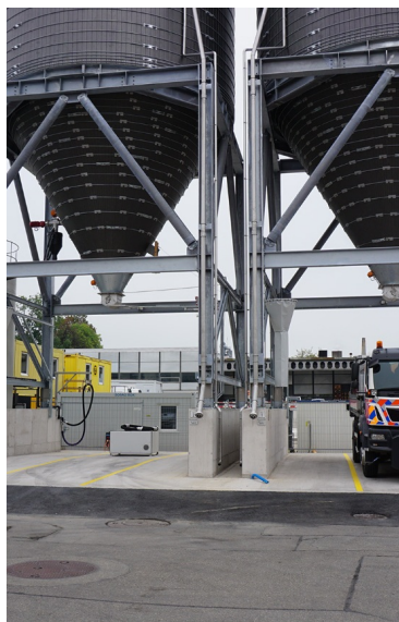
Soleerzeuger mit Lagertank und Steuertank
