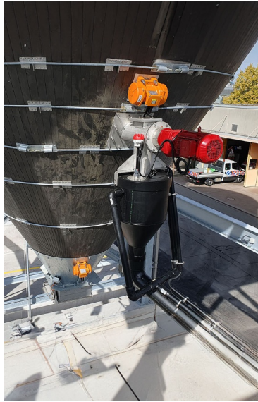
Soletankanlage mit Bedienstelle
